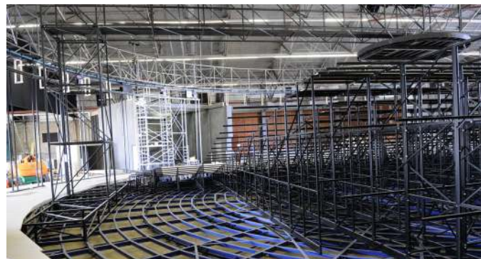
Blik op een deel van het podium. Boven is blauwe stroomrail (Stemann) te zien
